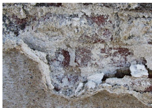
Typischer Schaden durch Salzausblühungen
